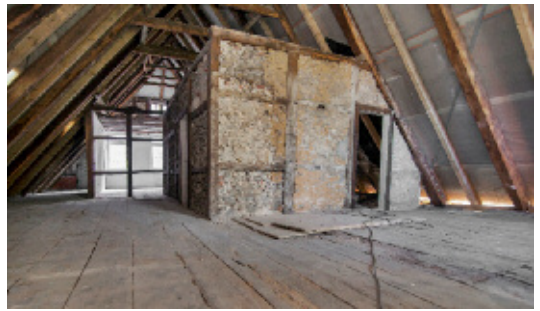
2 Der Innenraum des Dachgeschosses während der Bauphase 2015. Die Bruchsteinfüllungen in den eingestellten Fachwerkwänden sind aufgrund ihres erheblichen Gewichtes später in Teilbereichen entfernt worden.
